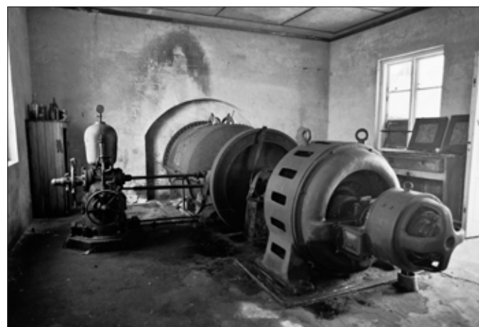
Generatoren i Burlidens kraftstation.
