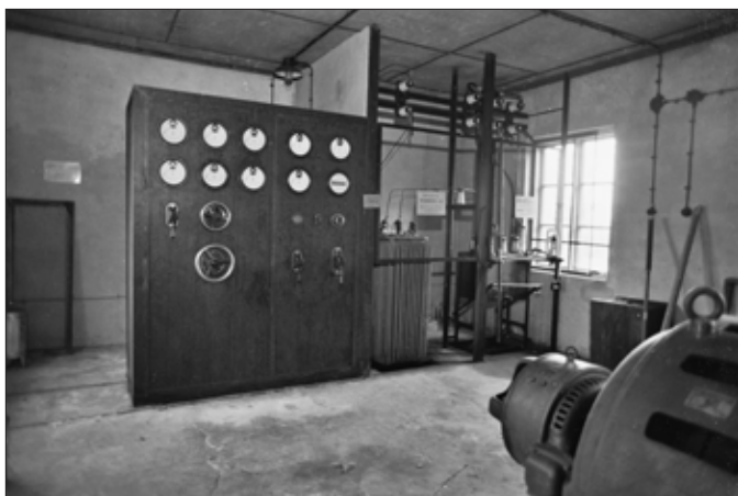
Kontrollpanel i Burlidens kraftstation.
